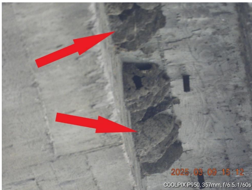
Fot. 2 - Kraków, Most Grunwaldzki, widok od strony Wawelu, pod pasem ruchu pieszego mostu, zaznaczono gniazda oknówek_20250309_
