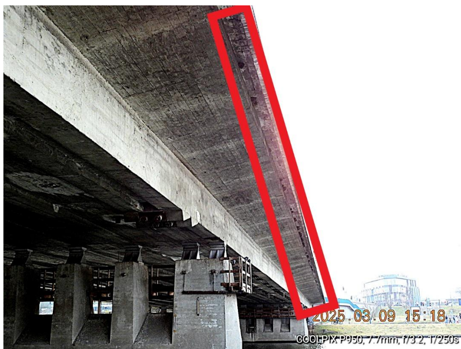
Fot. 1 - Kraków, Most Grunwaldzki, widok od strony Wawelu, pod pasem ruchu pieszego mostu, zaznaczono obszar, gdzie znajdują się liczne gniazda oknówek_20250309_
