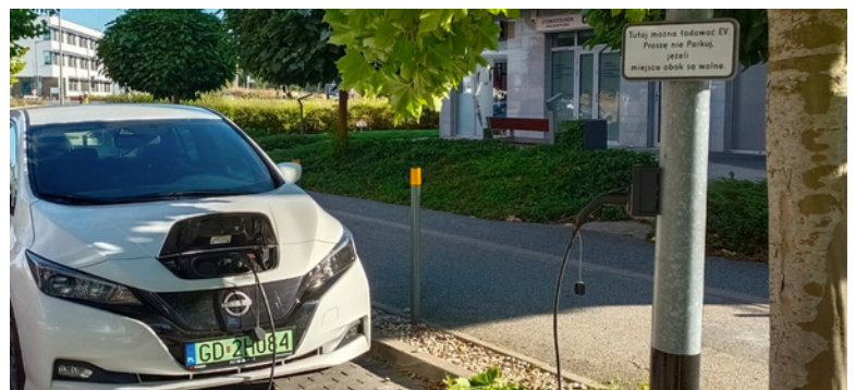
Ładowarka w latarni (Gdynia)
