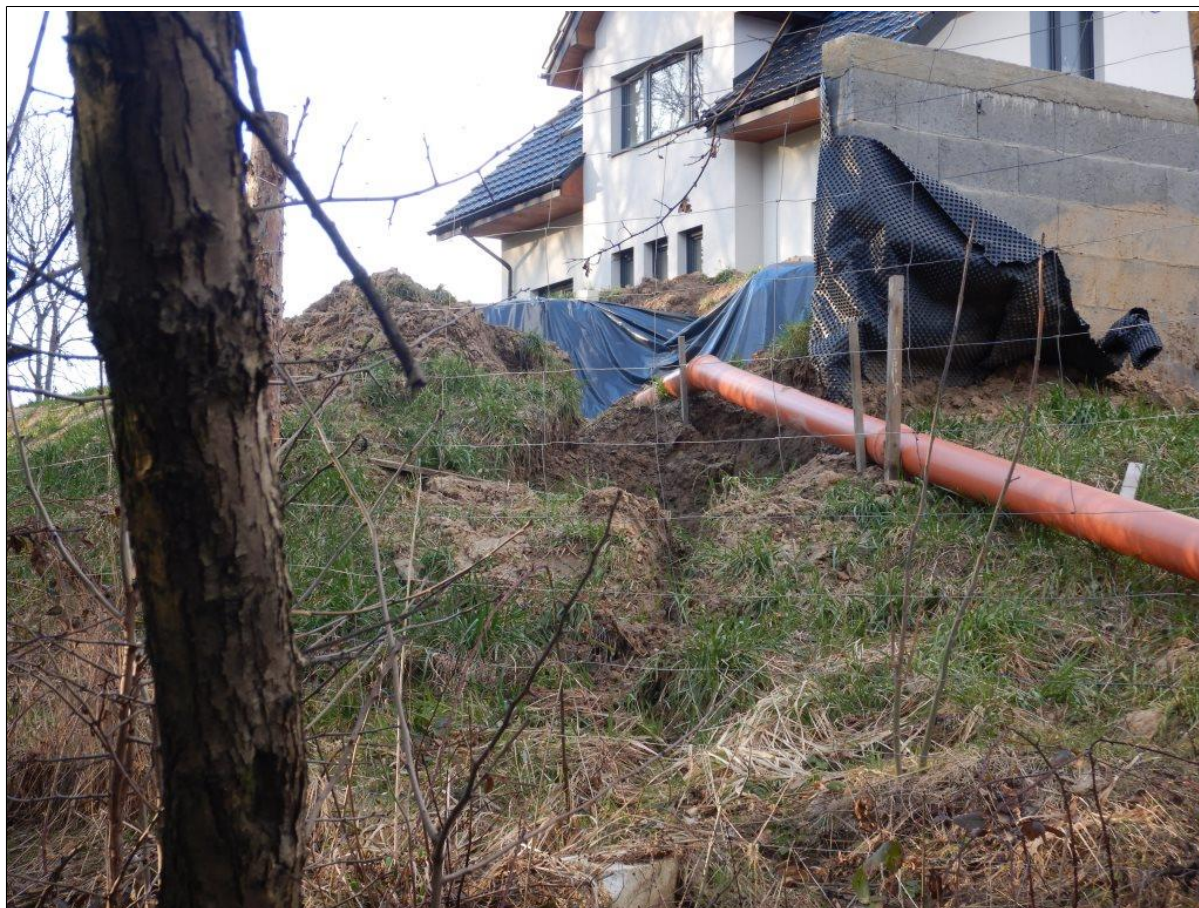
Widok na osuwisko od strony wschodniej
