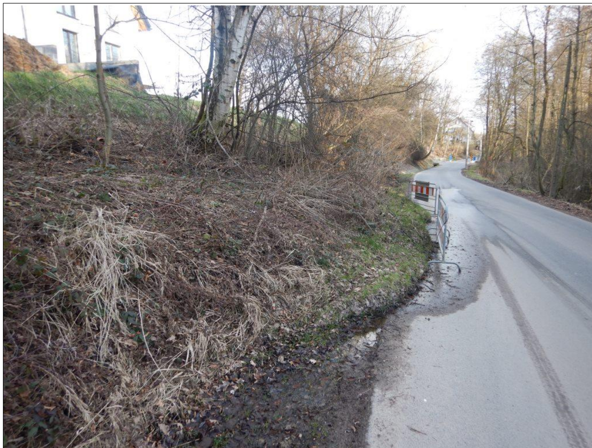
Widok na czoło osuwiska
