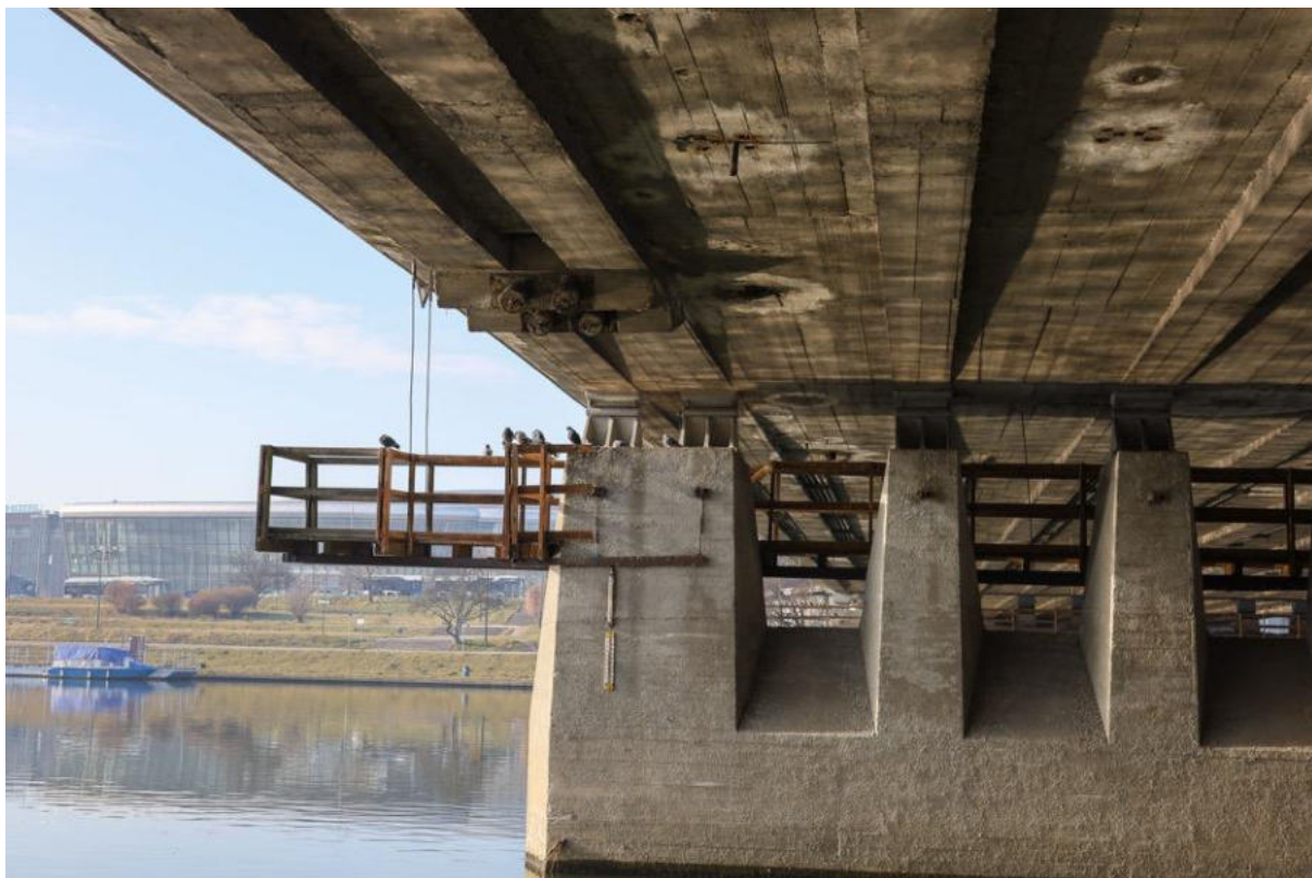
Fot. 13. Gołębie przesiadujące na filarach, gdzie brak jest zabezpieczeń przed ich przesiadywaniem.
