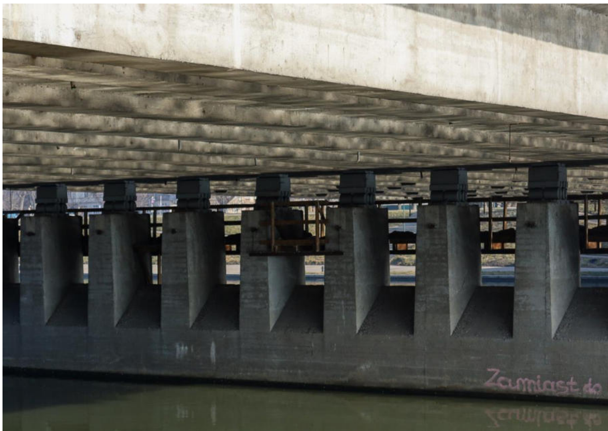
Fot. 11. Gołębie gniazdują prawdopodobnie na podporach mostu znajdujących się w korycie rzeki.
