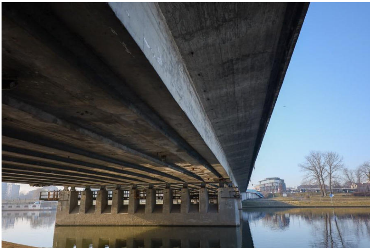
Fot. 9. Od spodu, most na większości konstrukcji, nie posiada śladów gniazd.
