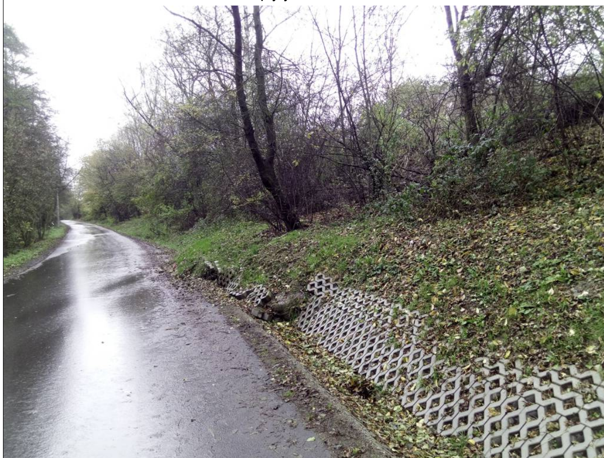
Fot. 2. Jęzor osuwiska zaciskający rów odwodnieniowy
