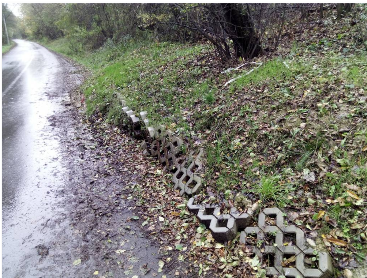
Fot. 3. Koluwia osuwiska i uszkodzone płyty ażurowe
